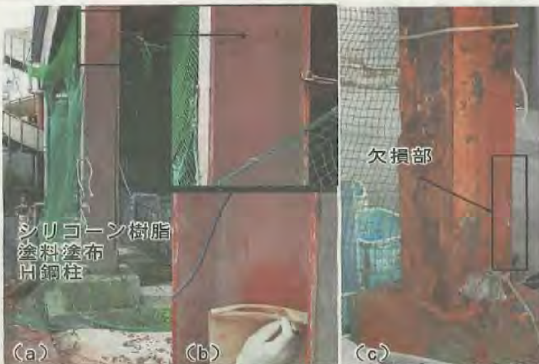
海岸大気中において施工後補修なしでおよそ40年経過したH鋼柱外観。a・bはシリコーン樹脂塗料塗布
